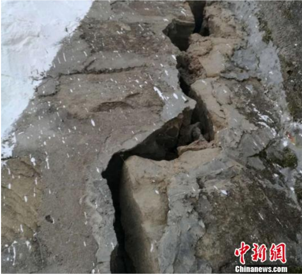
河堤曾泛起的裂痕。 民众供图
