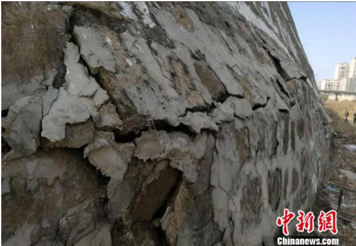
河堤曾泛起了严重的质量成绩。 民众供图
